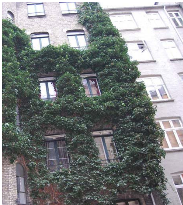
Figur 24. När klättrväxterna klättrar uppför fasaden kan stuprör och andra konstruktioner skadas.
