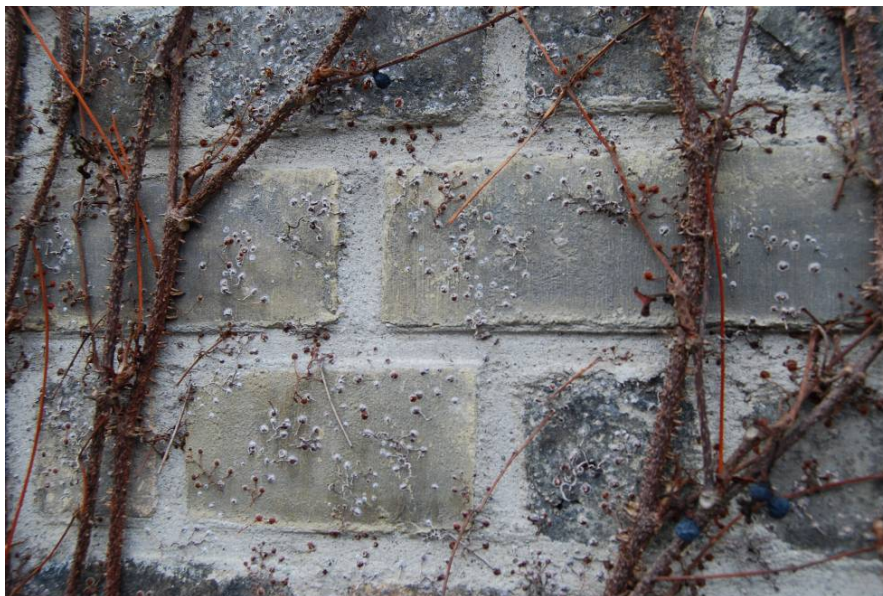
Figur 23. Vid borttagandet av klätterväxterna kan häftrotterna och häftskivorna lämna märken efter sig på fasaden.
