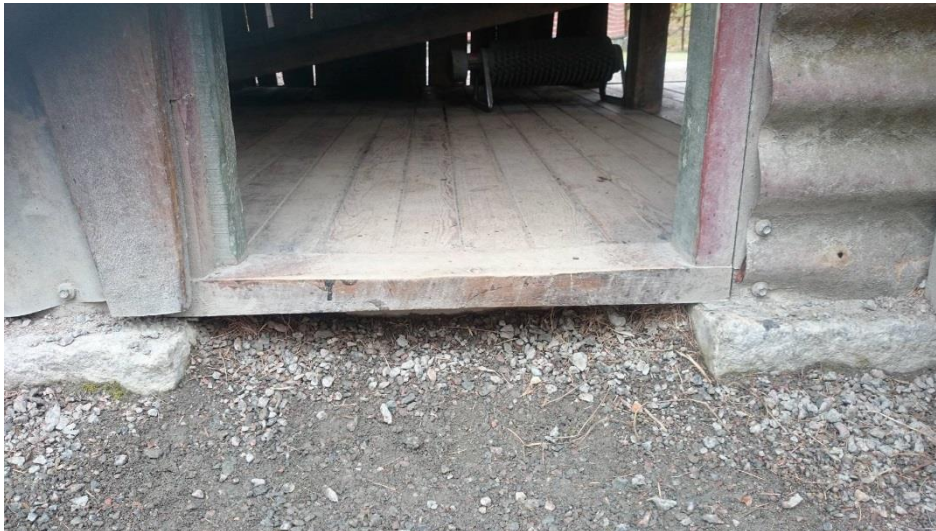
Trösklar hindrar några av husens entréer från att beträdas med hjälpmedel.
