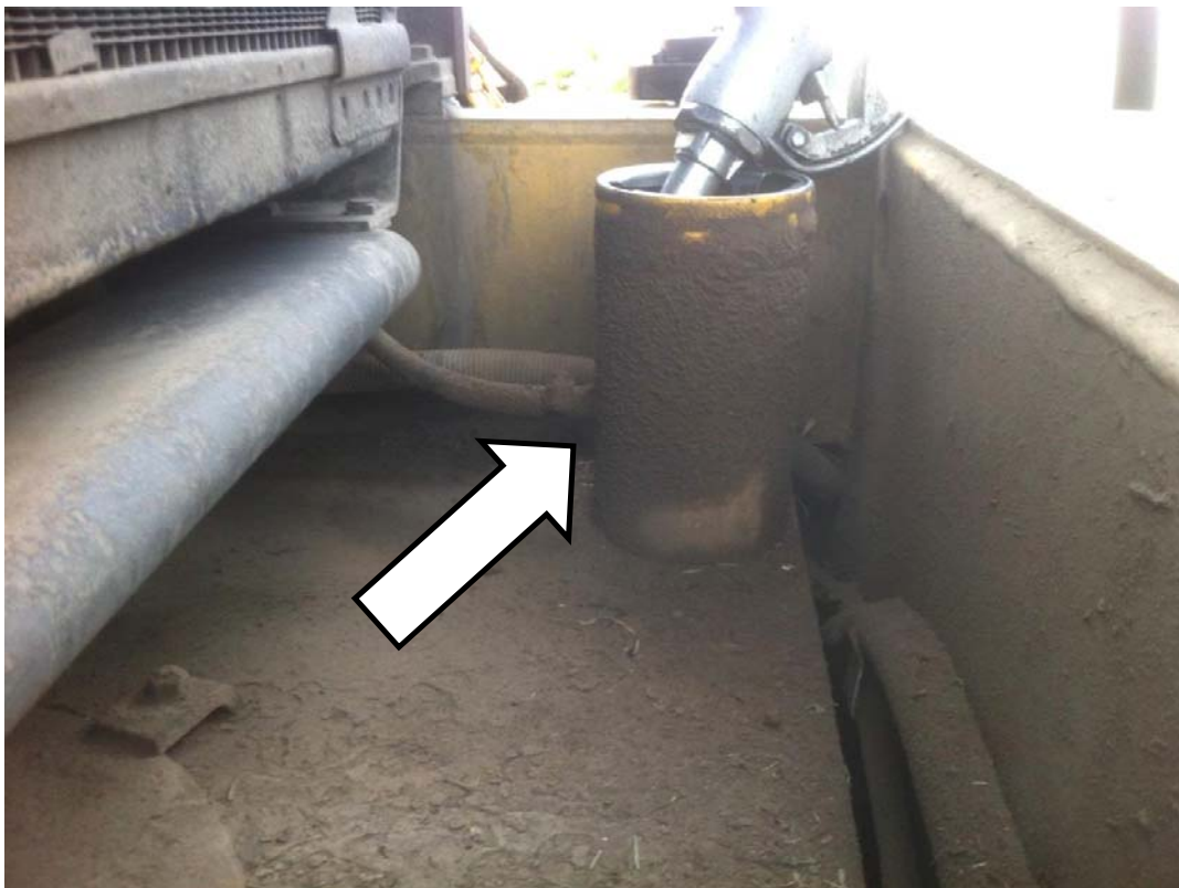
Figur 8. Luftningsrör som används som riktmärke för full tank.
