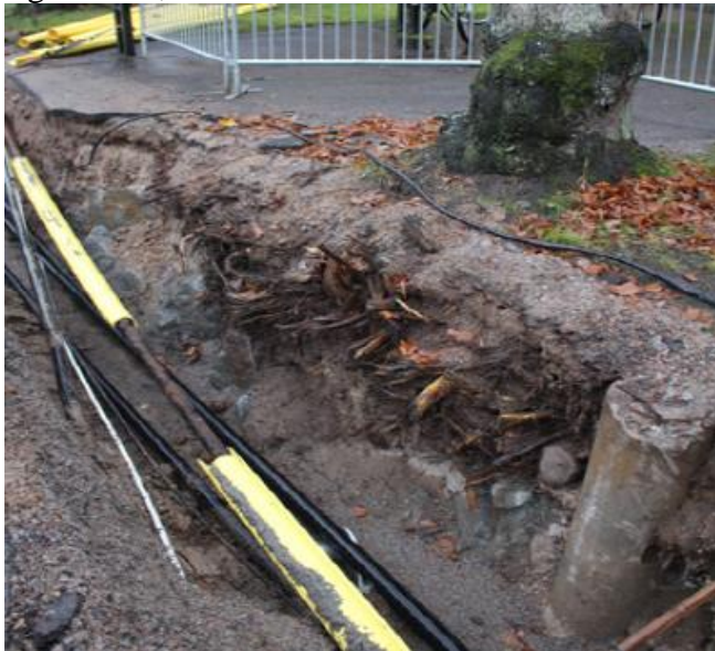
Fig. 5. Avgrävda rötter i samband med framdragnings av ledningar. (Andersson & Stål: Hur mår våra stadsträd?, 2015)
