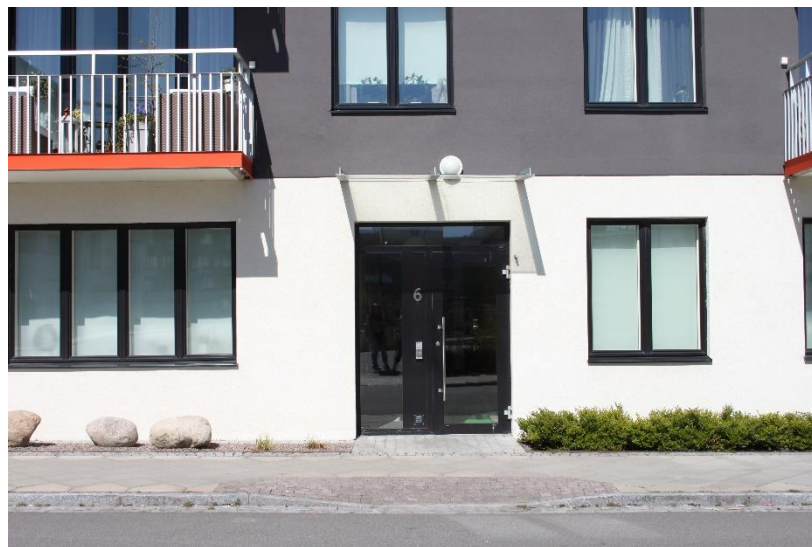
Två entréabatter i obalans, Västra Hamnen, Malmö.
