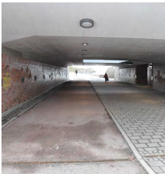
Belysningen under gångtunneln är otillräcklig.
