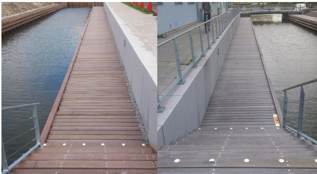
Figur 1. Fotokemisk nedbrytning i Lomma hamn, till vänster nyanlagt brygga av azobé. Till höger brygga av azobé anlagd ca ett år tidigare.
