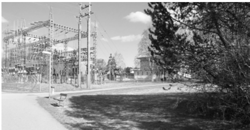
Transformatorstationen, och elledningarna som utgår från den kan både ses som en visuell barriär och ett landmärke.
