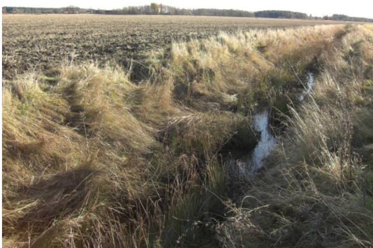
Figur 6. Bild på sträcka G som visar ras och bankar i vattenkanalen.
