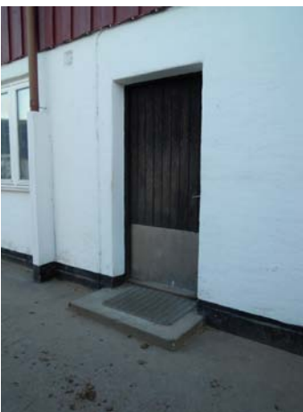
Figur 12. Vid ingången till sadelkammaren fanns en hög cementtröskel som hindrar rullstolsburna personer att på ett lätt sätt ta sig in genom dörren (Foto: S. Wisén).
