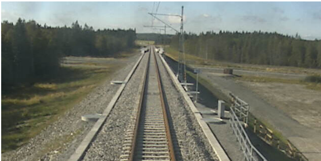
Stolpar med kontaktledningar utan hjälpkraftsledningar överst.
