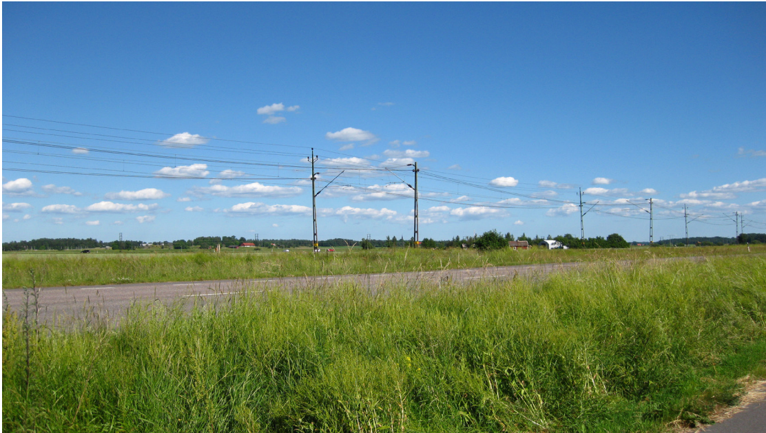
Stolpar med kontaktledningar och hjälpkraftsledningar överst.
