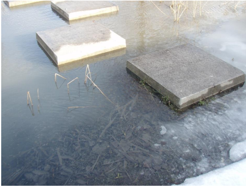
Figur 19. Granitblock vid inloppet från Valla å som sprider vattnet och därmed dämpar flödes hastigheter.
