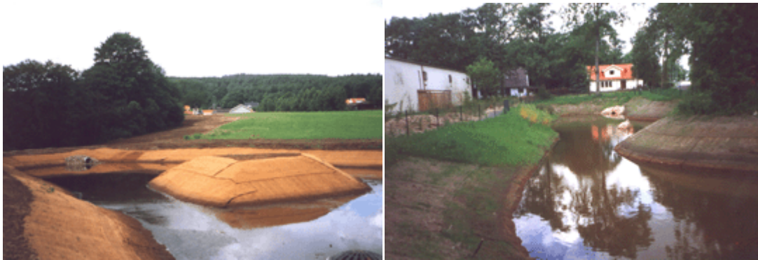
Figur 15. Bilden till vänster visar en damm under anläggning av erosionsskydd av nedbrytbara nät. Bilden till höger visar första sommaren efter anläggning. Källa och rättigheter THULICA AB.
