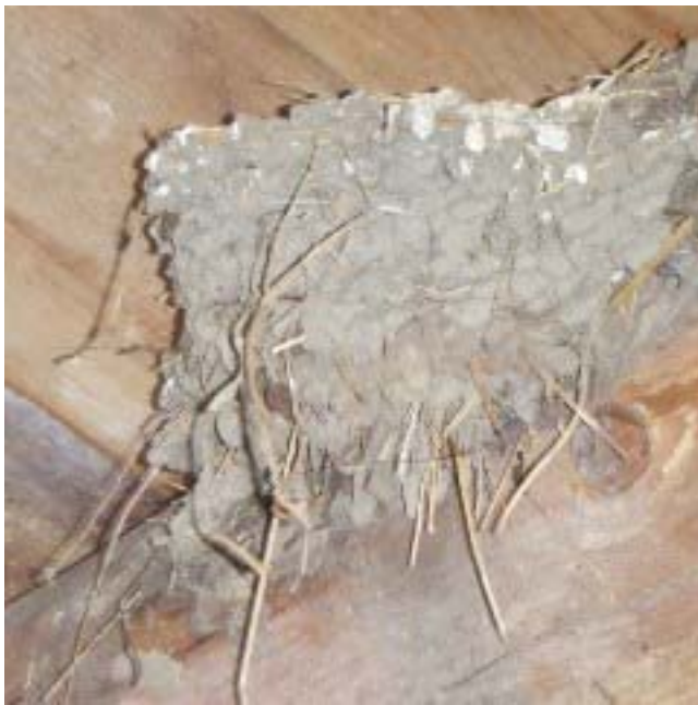
Figur 12. Svalbo i stall byggt i taket.
