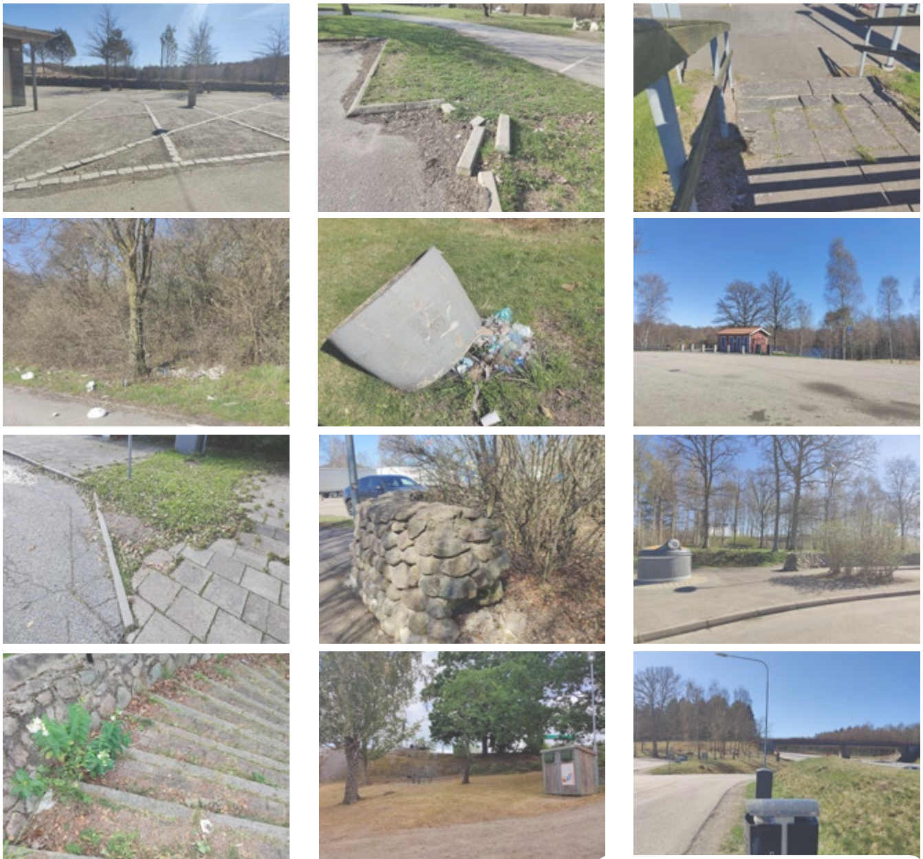
fig 69. Skräp, slitage och vandalisering
