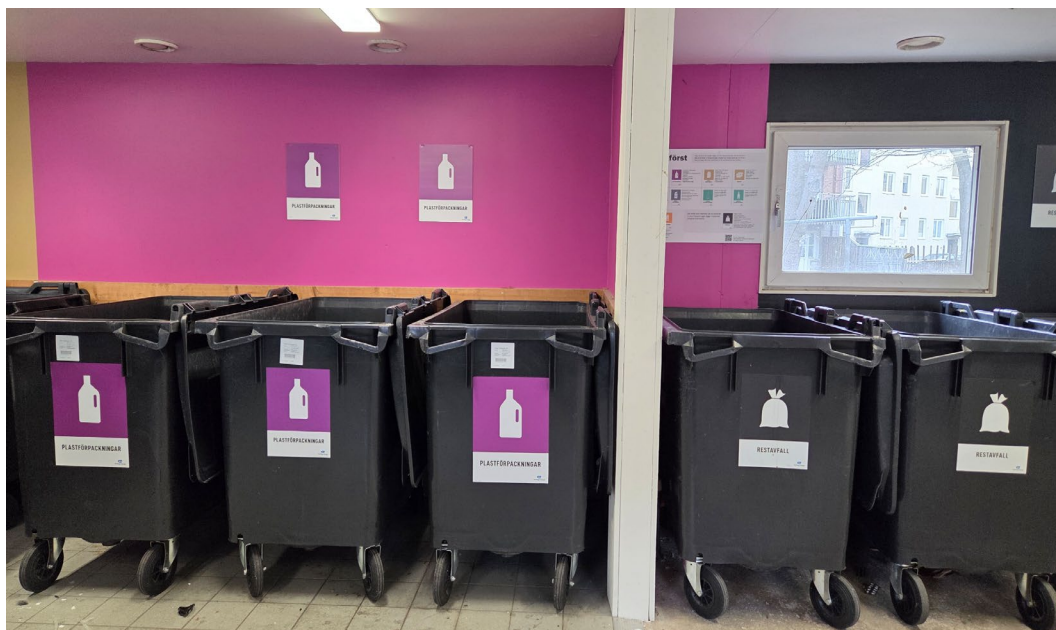
Figur 8. Miljöhus typ I. Område B. Bild på kärnen för plastförpackningar och restavfall med väggar målade efter fraktionsfärg, på väggen sorteringsinformation.
