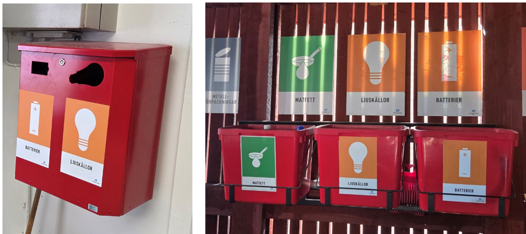
Figur 6. Olika typer av kärl för batterier och ljuskällor. Vänster: Miljöhus typ I. Område B. Vägghalterat kärl med anpassad öppning. Höger: Miljöhus typ II. Öppna plastbehållare monterade på väggen.
