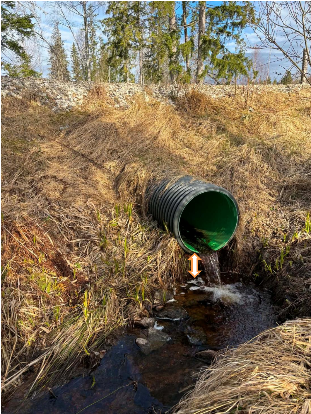
Figur 1. Hyttbäcken, vägtrumman är för högt placerad i förhållande till vattnet, pilen förtydligar detta.
