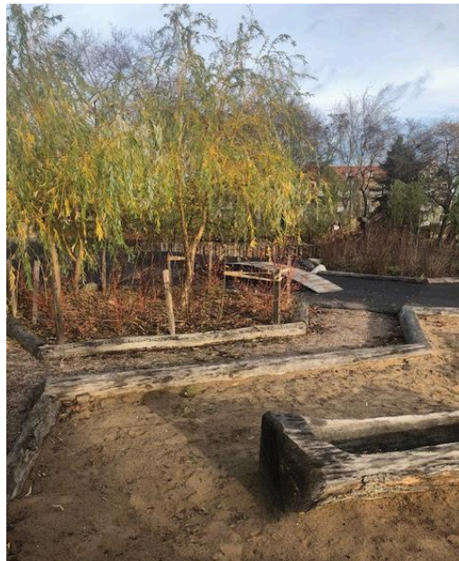
Figur 16. Kantstöd till lekplats och växtbädd. Slitage från lekande barn påskyndar bland annat nedbrytningsprocessen. Innergård, Västerås. Fotografi: Marcus Åkesson.
