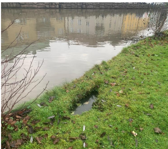
Figur 43. Erosion bakom träspont vid Mölndalsån i Göteborg (Eriksson 2025)
