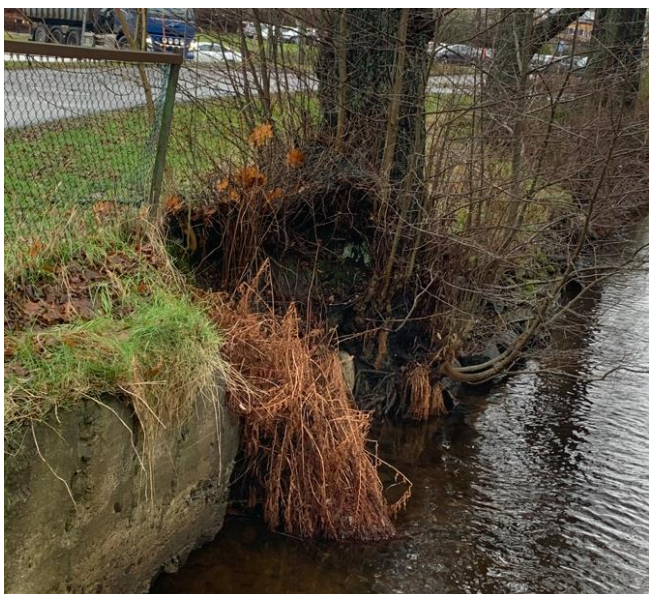
Figur 41. Eroderad slänt vid Mölndalsån i Mölnlycke, precis bredvid stödmur av betong (Eriksson 2025)
