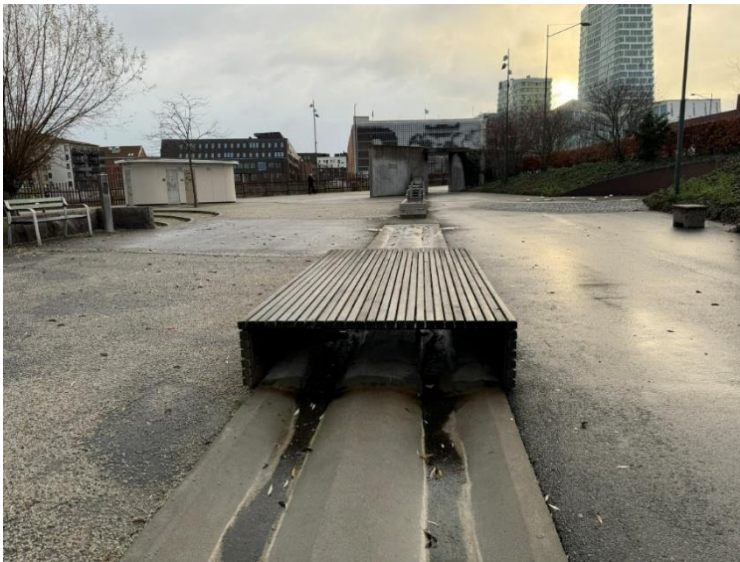
Figur 38 Den andra bänken där vattnet leds under och förbi bänken.
