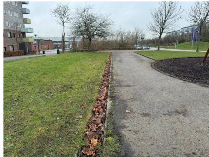
Figur 56. Rännan är fylld med fallna löv.
