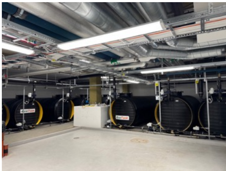
Figur 29. Regnvattentankar som magasinerar takvattnet i Sergelhuset (Ferm 2025)
