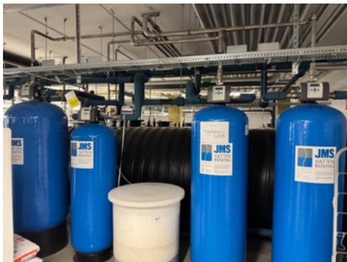
Figur 30. Reningsanläggningen som behandlar takvattnet i källaren i Sergelhuset (Ferm 2025)
