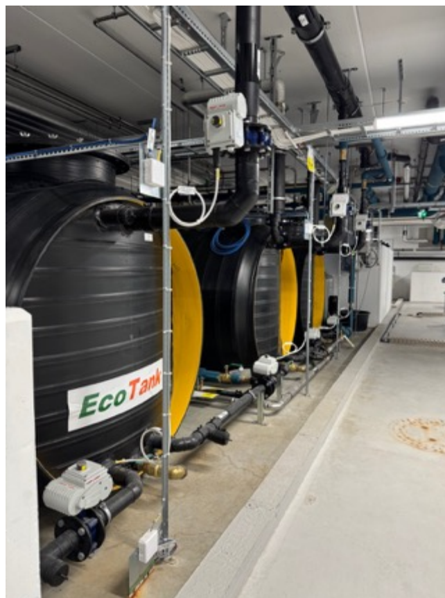
Figur 15. Vattentankar för magasinering av regnvatten som samlas in från tak. (Ferm 2025).
