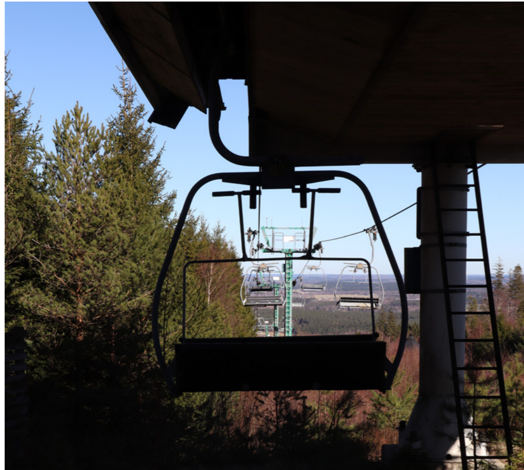
Figur 5. Liften har troligtvis inte använts senaste tiden vid , gran och slyvegetation har vuxit upp vid avstigningen.
