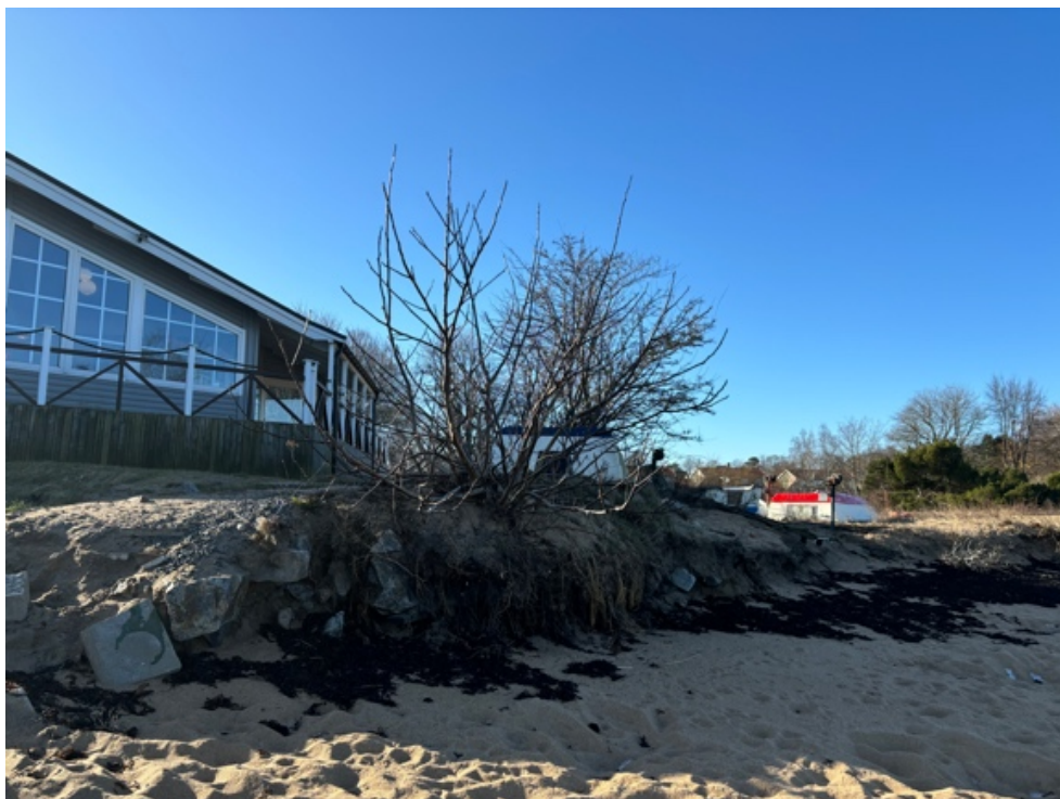
Figur 9. Bild på erosion av stranden, där rötterna tydligt har spolats fram.
