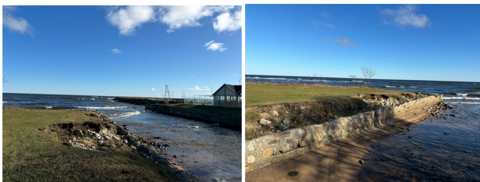
Figur 11. Bilder på mynningen av Tommarpsån, där delar av marken vid muren har spolats bort.
