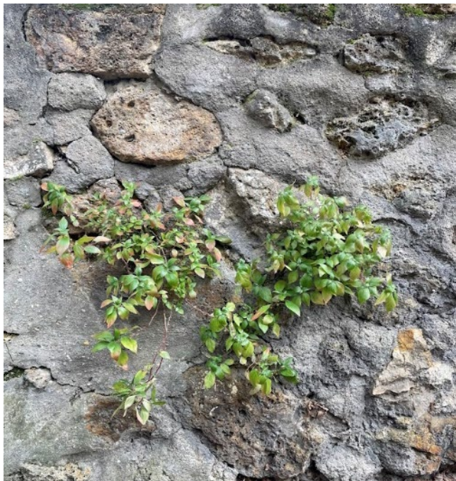
Fig. 8. Väggört ( Parietaria officinalis ) som funnit växtplats i en mur med sprickor och håligheter.
