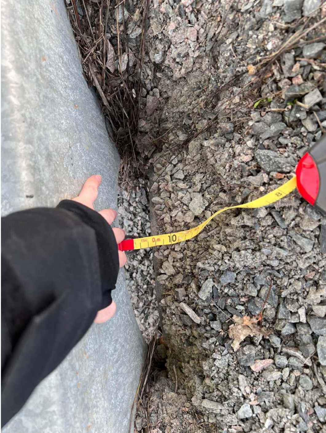
Figur 5. Konstruktionsbrist mellan ledarm och trumma framifrån med måttband.
