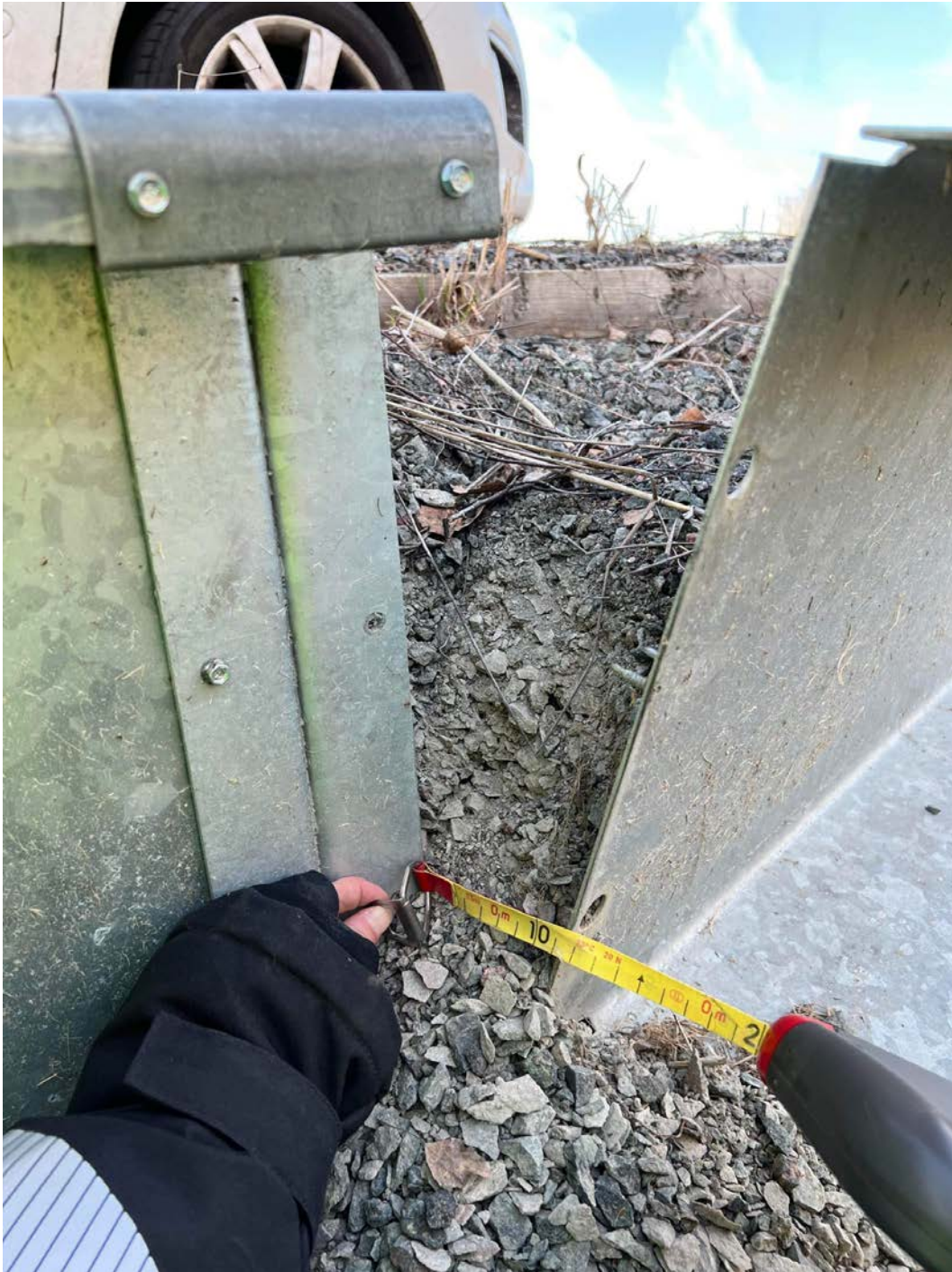
Figur 3. Konstruktionsbrist vid ledarm som brustit med måttband.
