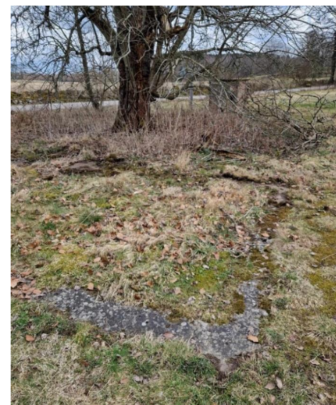
Figur 21. Gräs, mossor, sly och en sälg växer i fundamentet till vagnsvågen. Foto: Författaren
