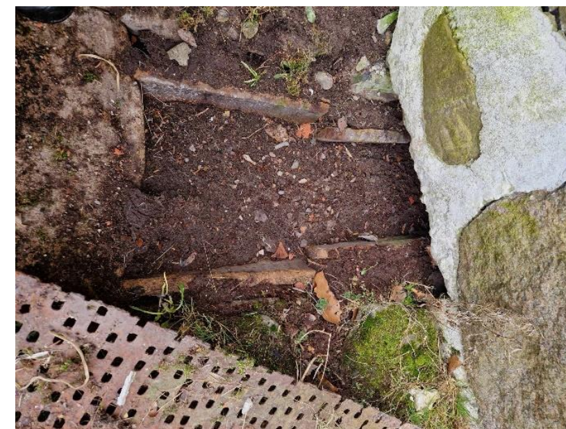
Figur 25. Rännan är i stengods och går från betongplattan under väggen och in i byggnaden. Foto: Författaren
