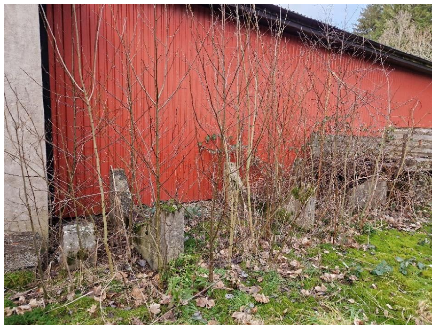
Figur 44. Betongfundament förr hållande råoljecistern som förvarade bränsle åt brännvinsproduktionen. Idag kraftigt överväxt av sly. Foto: Författaren
