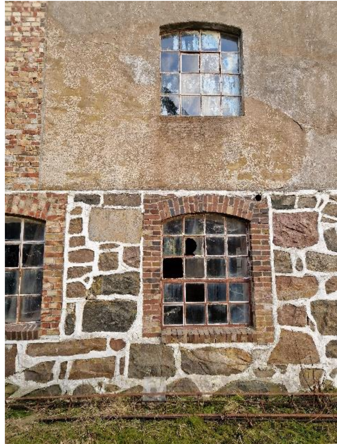
Figur 53. Västra sidan av byggnaden som vetter mot Brandsberga gård har trasiga fönster intill den nu överväxta grusvägen. Foto: Författaren
