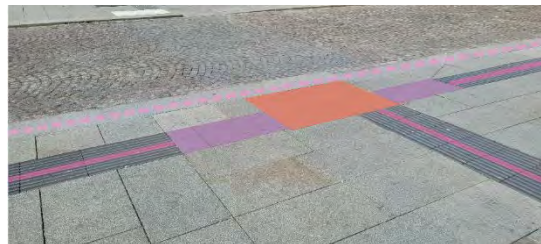
Figur 21: Korsningen mellan de olika ledstråken har kombinerats med varningsytan, vilket har lett till att valytorna snarare har blivit glapp i ledstråken än ledning.
