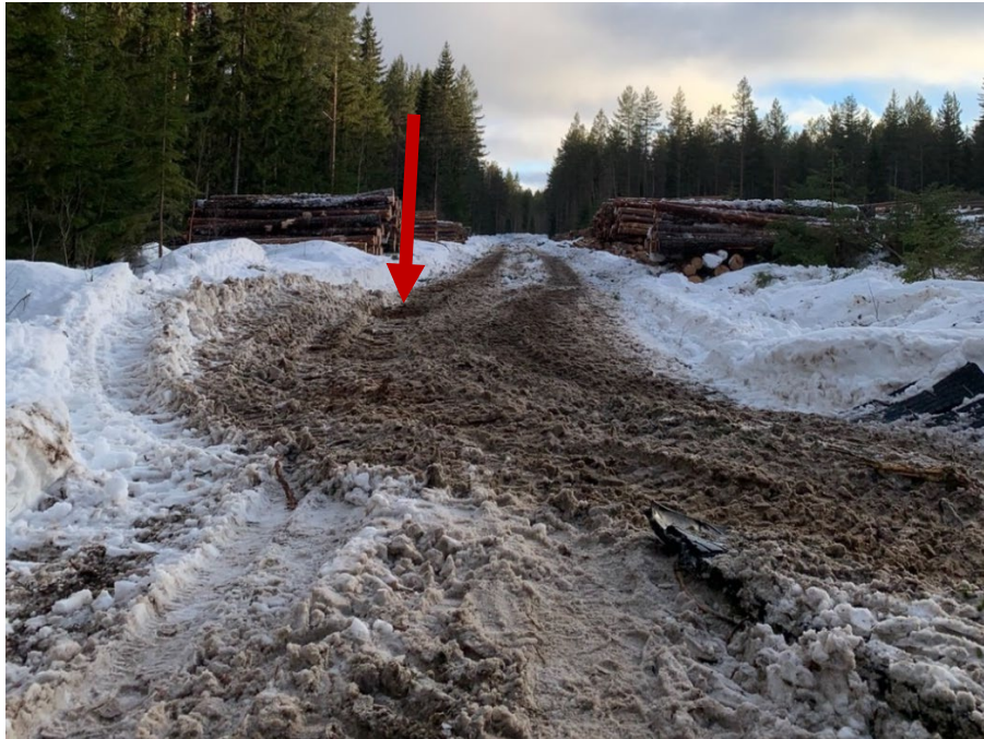
Figur 5. Bild av det dubbelsidiga avlägget efter 16 lass, pilen indikerar var vägskada uppstått.
