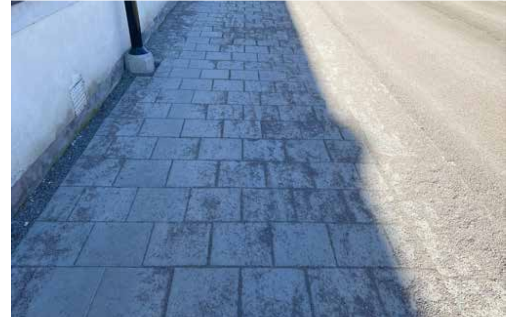
Figur 44: Trottoaren mot fasaderna längs Västra Ågatan är belagd med betongplattor och likt den asfalterade trottoaren längs åkanten är det borgmästarsten som kantstöd.
