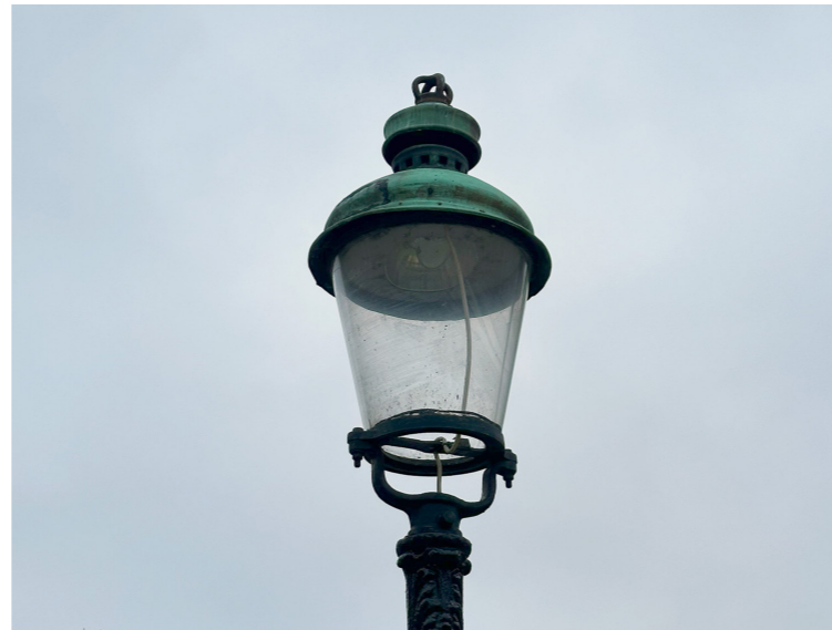
Figur 13. Befintlig armatur på torget.
