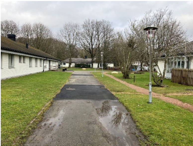
Figur 22. Sliten och lagad huvudgång av asfalt mellan hus B och C. (Robert Dapcevski 2024)
