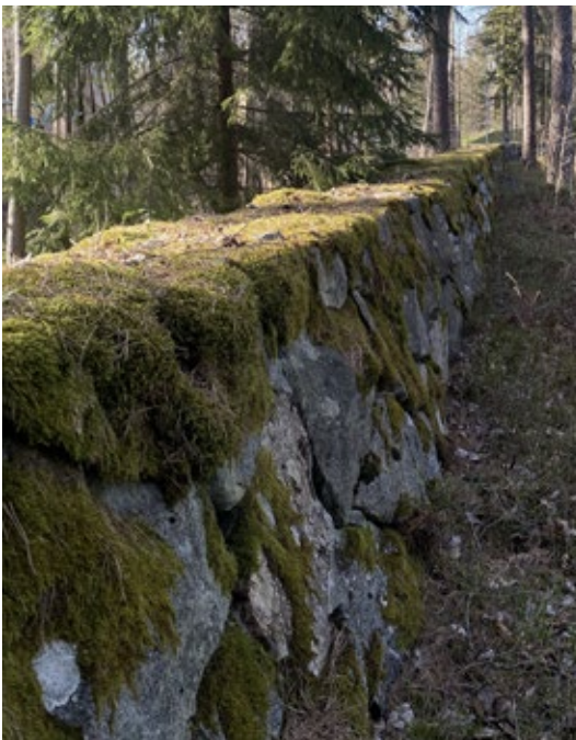
23 / Kyrkogårdsmuren utgör en viktig livsmiljö med håligheter och sprickor.
