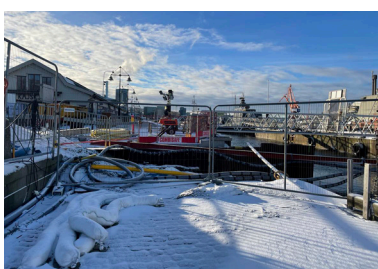
Figur 89: Avspärning mellan renoverade och orenoverade delen av Packhuskajen. Bilden visar att den renoverade delen blir något högre.
