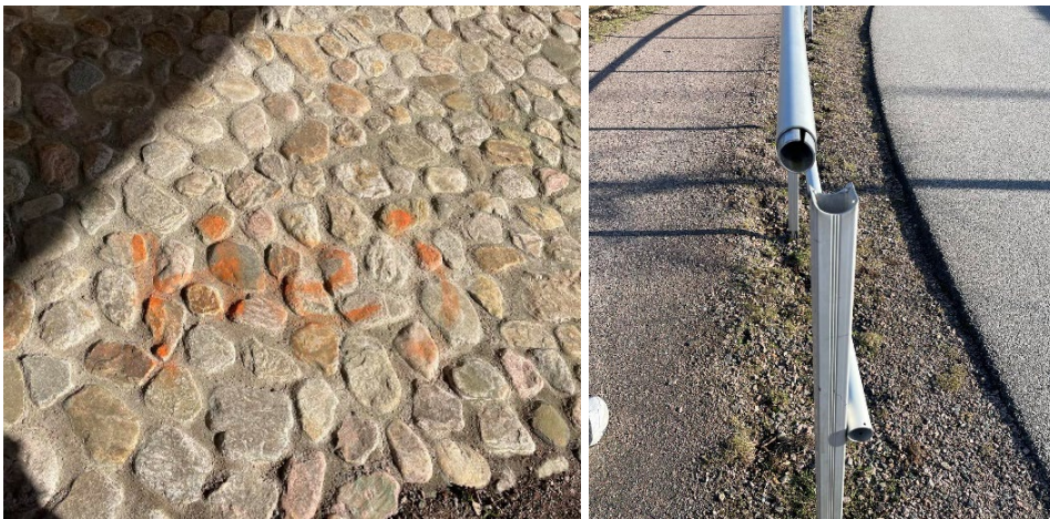
Bild 46 och 47. Vänster bild visar klotter mot stenslätten. Höger bild visar räcket mellan gång- och cykelbanan som var trasigt.
