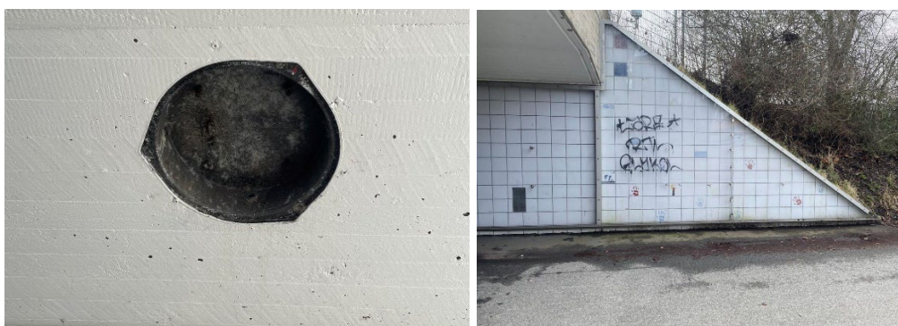
Bild 36 och 37. Vänster bild visar hålet i taket där gammal belysningsarmatur suttit. Höger bild visar graffiti i början av tunneln.
