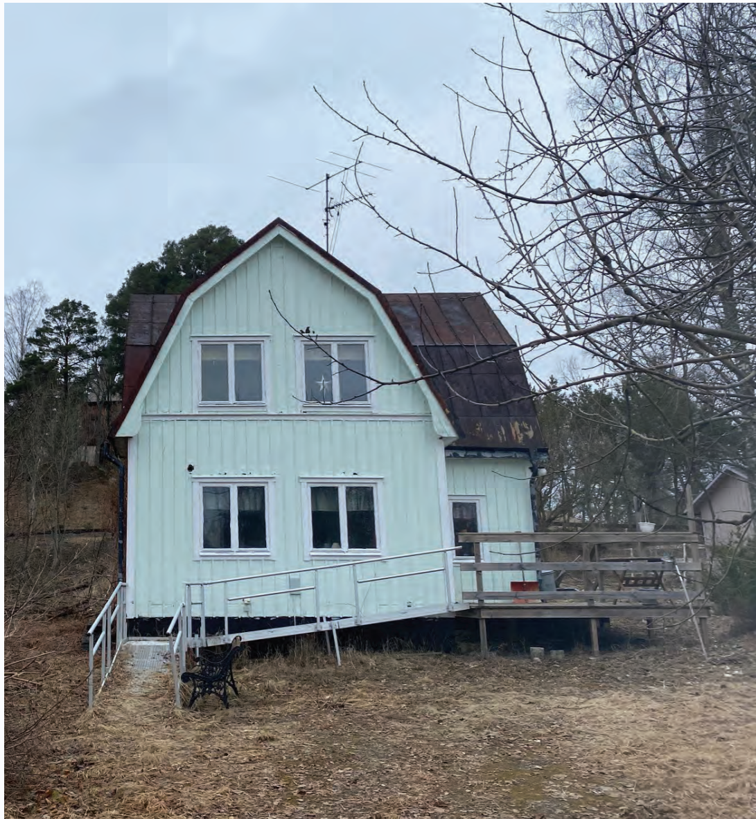
Figur 17 Byggnaden som ska rivas för att göra rum för den nya utombusscenen är i ett dåligt skick.
