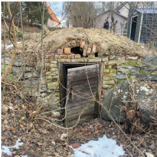
Figur 27 Jordkällaren i ett skick som bara kan beskrivas som fallfärdigt.
