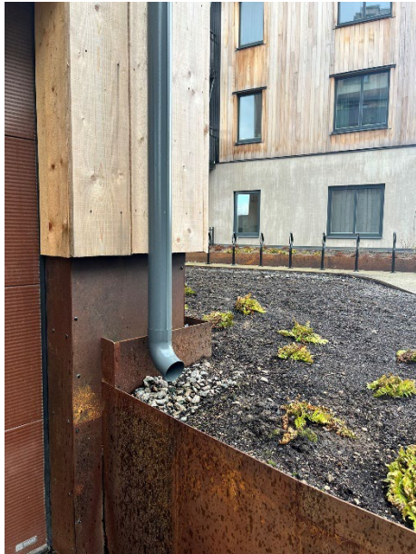
Figur 4. Stuprör som leds ut i växtbädd, Växjö
