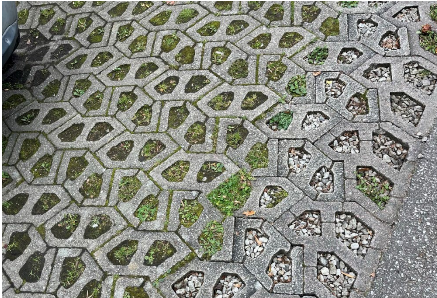
Figur 6. Gräs- och grusarmerade plattor på parkeringsplats som infiltrerar vatten, Alnarp
