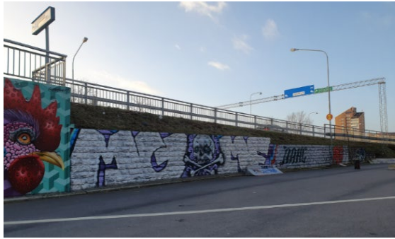
Figur 12. Bilden visar stödmuren på norra sidan av trappan. Asfaltsytan används för skateboard-åkning.
