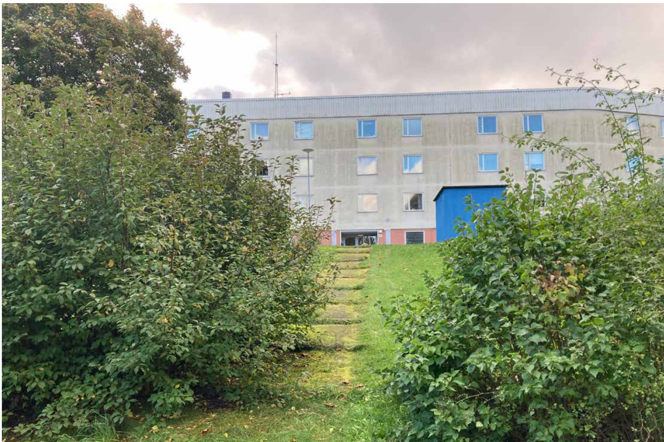
Figur 36. Tryggheten påverkas av nedsatt skötsel. Flerfamiljshuset är planerat med stora närliggande ytor för lek- och fritidsändamål. Denna igenvuxna åsnetrappa sammankopplar bostadshuset med bollplaner och promenadstråk. Den slitna fasaden, mossan, buskar över gångvägen samt träd och mossor på bollplanerna sänder signalen att detta inte är en plats som prioriteras. Foto författaren 2023.
