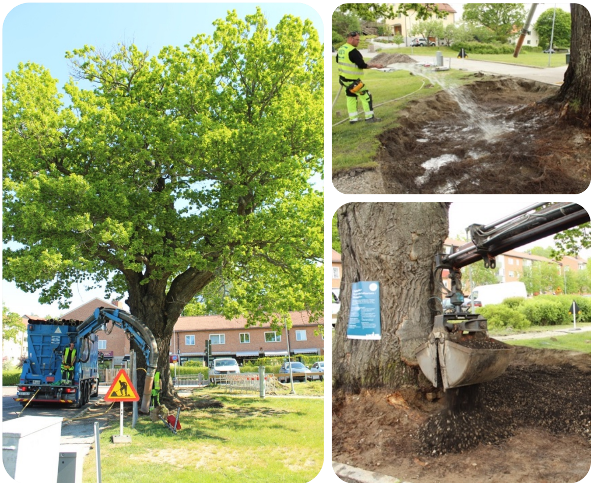
Figur 5: Vakuumschakt av Sätträängseken (till vänster), rötter hålls fuktiga efter schaktning (överst till höger) och påfyllning av nytt substrat (längst ned till höger). Foto: Karin Almén
