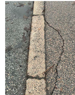
Figur 38. Sprickor i den gamla asfalts beläggningen.
