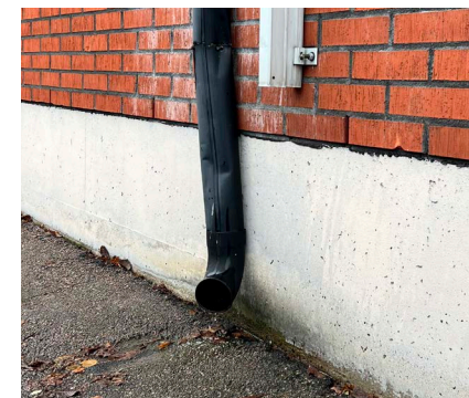
Figur 26. Stuprör som leder dagvatten ut på gatan.
