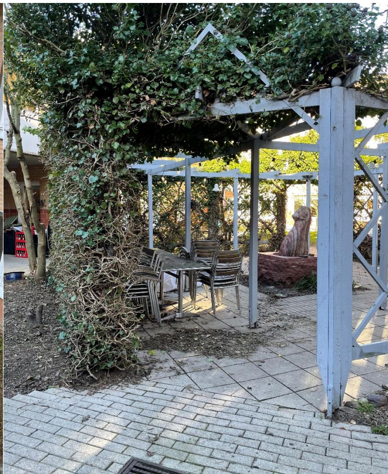
④ Det befintliga torget ligger centralt på inngården och har övervägande full sol över hela dagen. Statyn syns längre bak i bild som önskas behållas. Stolparna i pergolan försämrar tillgängligheten att ta sig runt på torget. Foto: Karoline Klingborg 27/01/23
