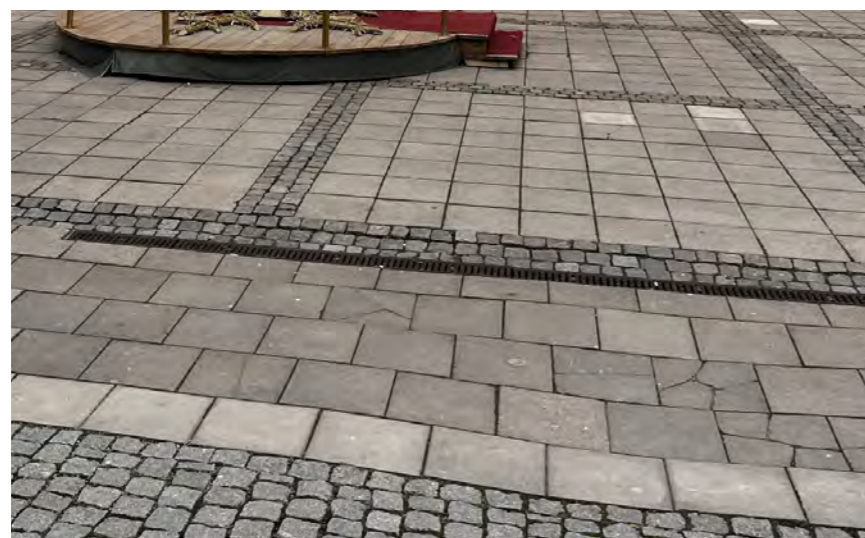
Figur 98 - Spruckna betongplattor, färgsättning på markbeläggning.
