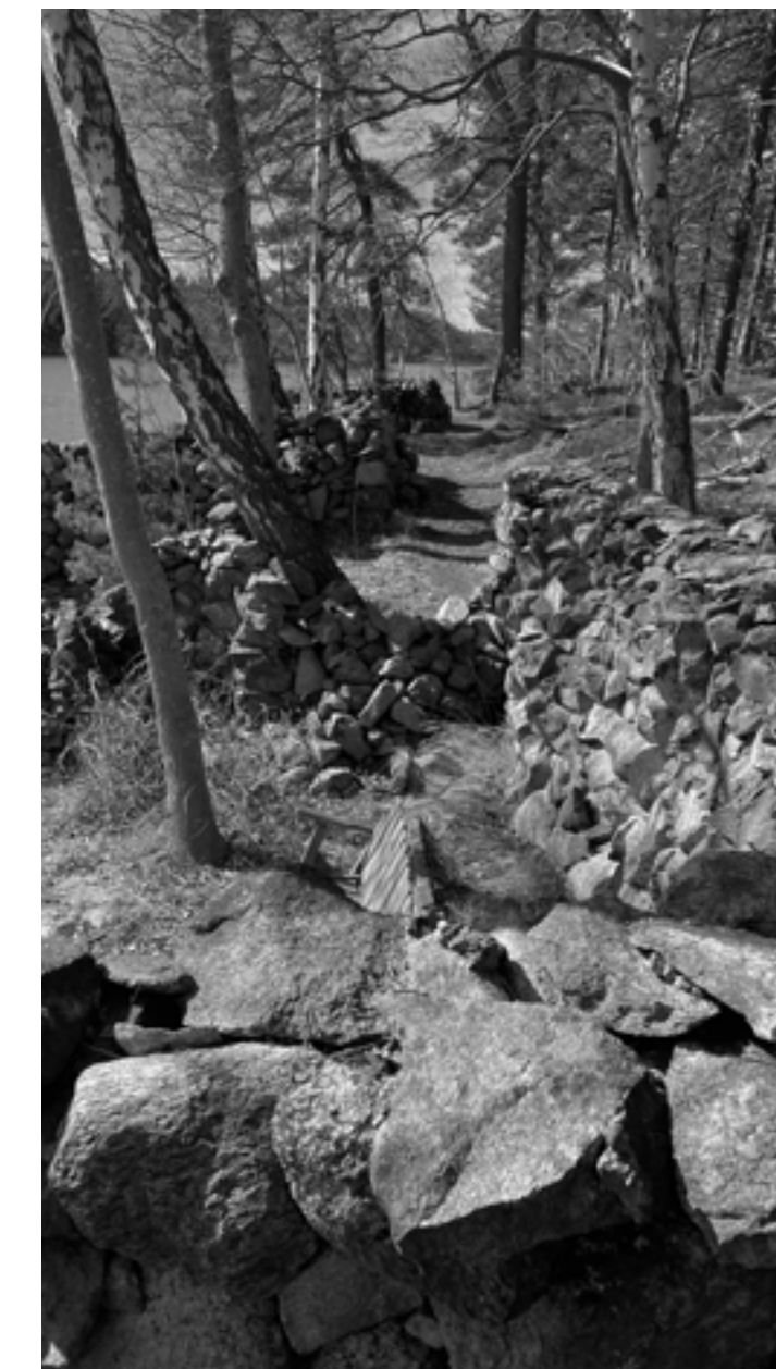
Figur 43. Solgrottorna är uppförda med en teknik där man kallmurade stenarna utan bindningsmedel vilket bidragit till att några har rämnat.
