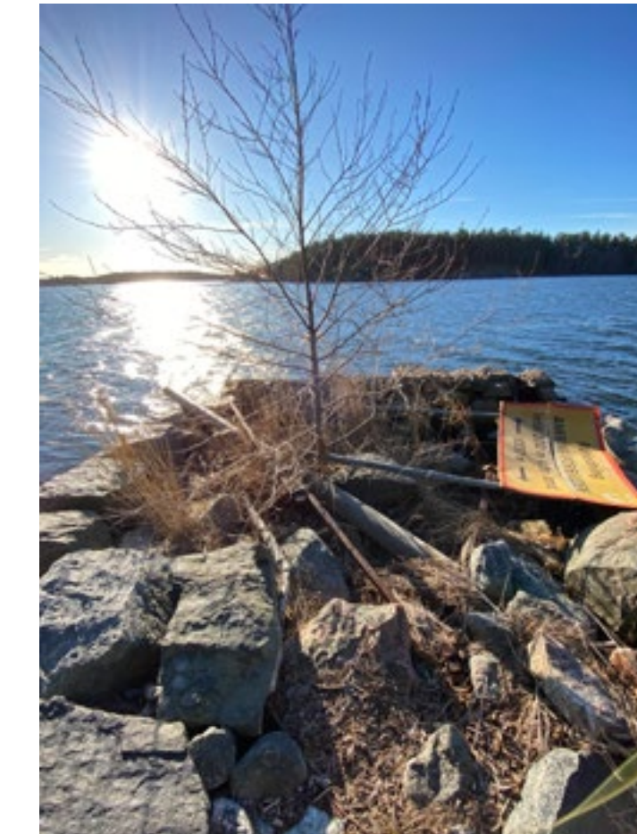
Figur 47. Befintligt skick på stenkistan av militärt ursprung. Antikvarie rekommenderar att den restaureras.
