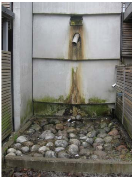
Bild 10. Algbevuxen betongvägg där det rinner vatten genom ett rör från den övre till den nedre delen av en bostadsgård.
