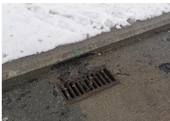
Figur 7, Eventuellt inlopp för dagvatten i kantstöd samt dagvattenbrunn på cykelväg. Foto: Privat
