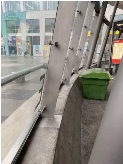
Figur 11. Hyllie stationstorg; fundamentet på insidan av glaskupolen är för smalt för att sitta på.
