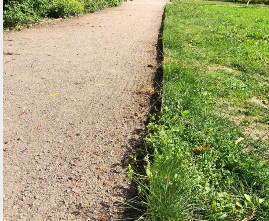
Uppstickande kantstål skapar svårigheter vid klippning. Det bildas en grässtripa längs med kantstålet som behöver trimmas ner för att bibehålla det planerade estetiska uttrycket. Denna lösning försvårar även för avrinningen.
