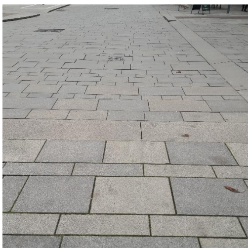
Figur 15 - Svårt att se avgränsning mellan upphöjd gångbana och körbana.
