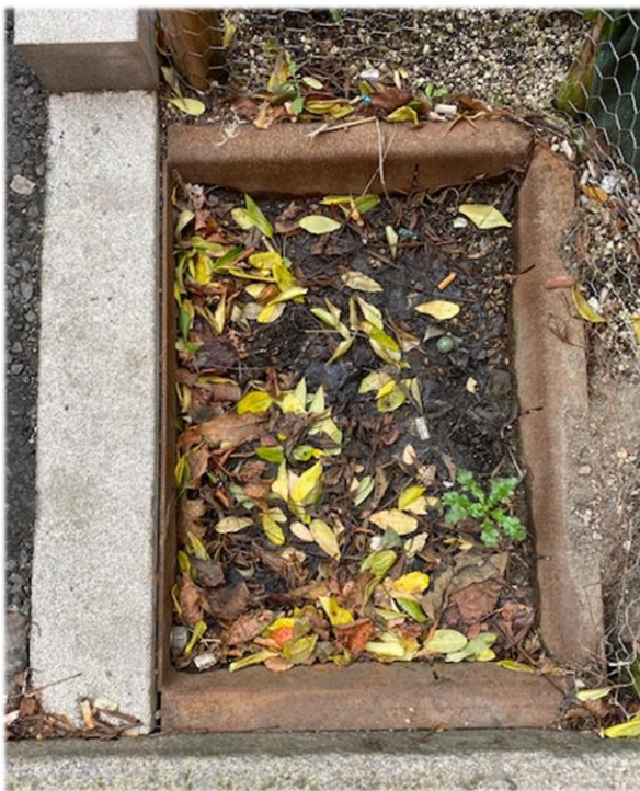
Figur 6. Bild till vänster, inlopp till regnbädd med ett sandfång.
