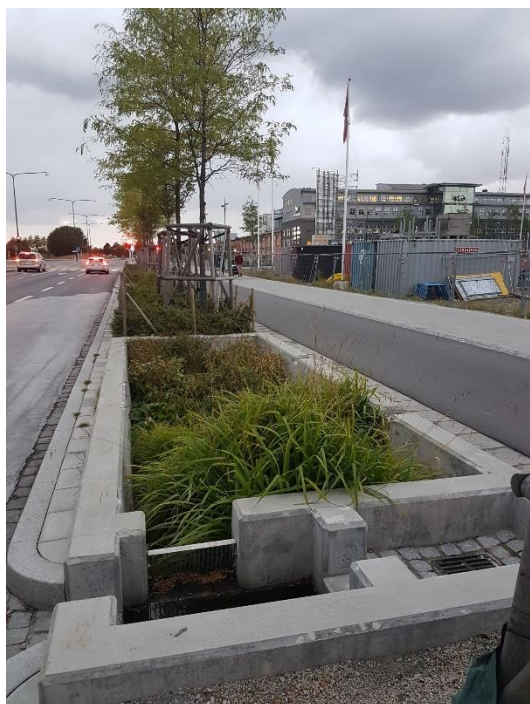
Figur 22. Biofilter med inlopp från bilväg, Neptunigatan Malmö. Dagvattnet samlas i den inledande betongkistan och silas genom ett metallgaller till den nedsänkta växtbädden. Stenhögar är placerade vid varje inlopp för att motverka erosion och vid stora flöden bräddas till dagvattenbrunnen till höger.
