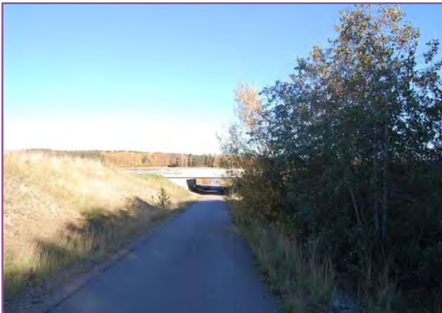
Figur 57. Brist: där Linnéstigen går är det asfalt en bra bit under undergången, men inte på den strax norr om denna.
